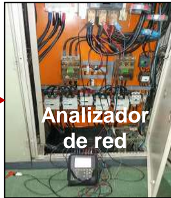
Panel eléctrico del Transformador
